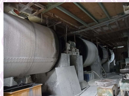
▲ 手前2台が昭和44年に 据え付けたボールミル
